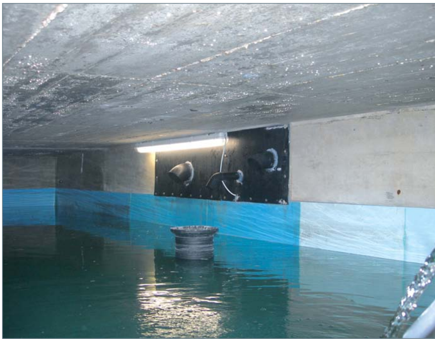
■ Abbildung 3: Wasserspeicher mit Tauwasserausfall auf der Betondecke
